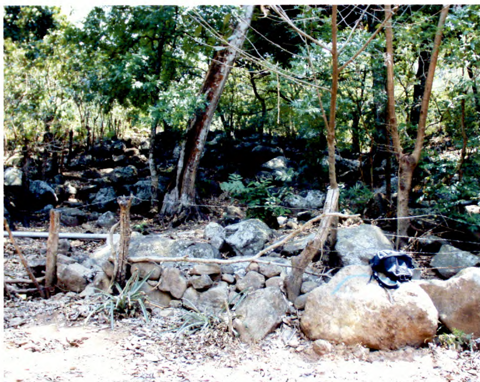
Foto No. 16: Depósitos inconsistentes de los flujos torrenciales, lecho de la Quebrada Honda. Estos depositos podrían hacerse objeto de retransporte y deposición destructiva.
